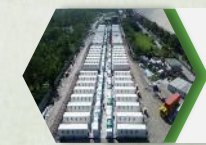
和平 BESS 100MW / E-dReg 50MW 併聯運轉中
